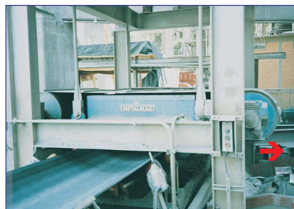
As impurezas capturadas são arremessadas para fora da correia transportadora
